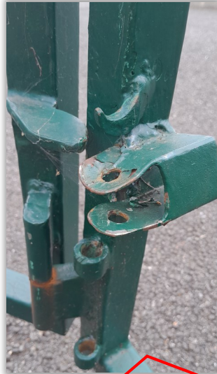
Remplacement cadenas arraché : 109 €
