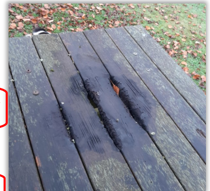
Dégradation table city stade à remplacer : 600 €
